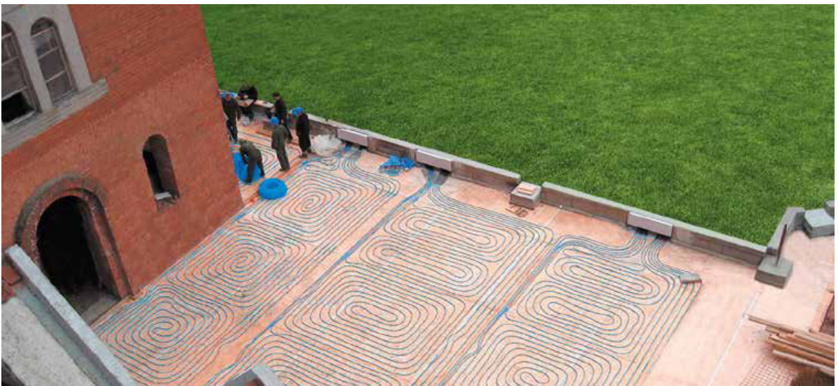
5. Ábra Kültéri terasz fűtési rendszer a KAN-therm rendszer bluePERT csövek alkalmazásával.
